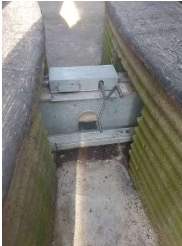
Slika 34. Zasun lančanog transportera u oklopu Redler za pražnjenje silo komora (Izvor: Lukačević, M.)
