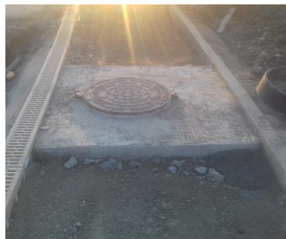
Slika 5) Šahtovi uz kanalice koje upijaju oborinsku vodu (Izvor: Autor, 2020.)
