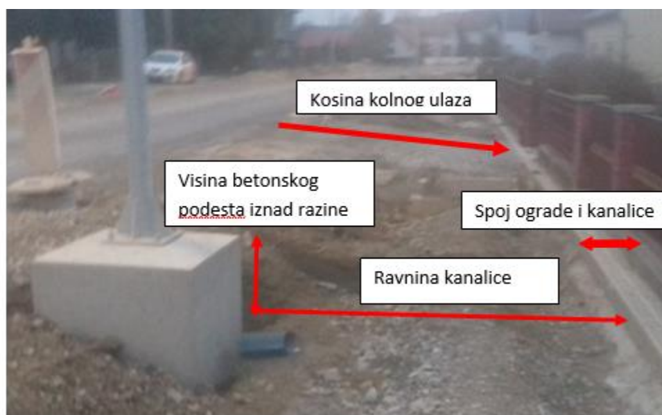
Slika 8) Betonski stupovi za rasvjetna tijela koji nisu postavljeni na način da ih zelena površina skriva, tj. da su postavljeni u razini košnje travnjaka, već strše (Izvor: Autor, 2020.)
