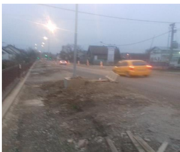
Slika 4) Postavljena rasvjetna tijela (Izvor: Autor, 2020.)
