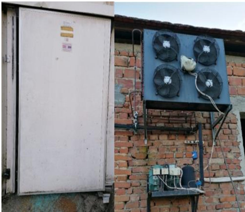
Slika 21. Hladnjača za skladištenje mrkve
