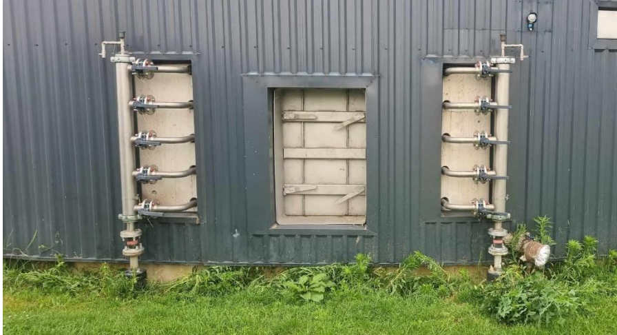
Slika 13. Cijevi za odvod i dovod topline u digestor
