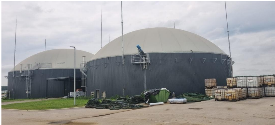
Slika 8. Digestor i postdigestor
