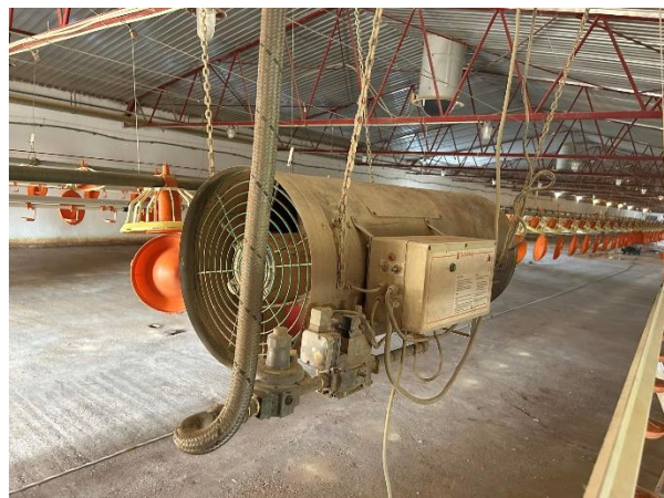
Sl. 7. Sustav za zagrijavanje objekta
