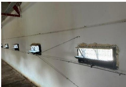
Sl. 11. Sustav za rashlađivanje objekta (Izvor: Mislav Bilen)
