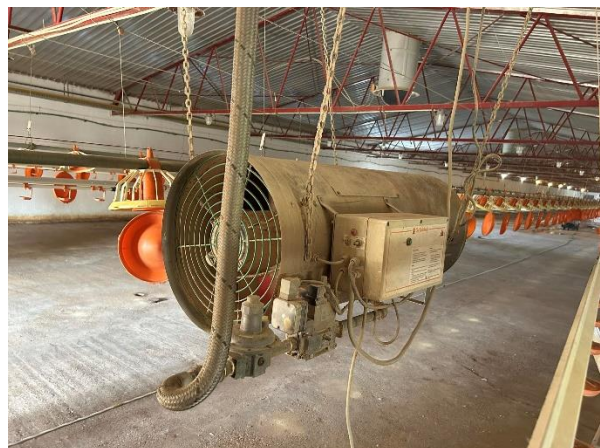
Sl. 7. Sustav za zagrijavanje objekta
