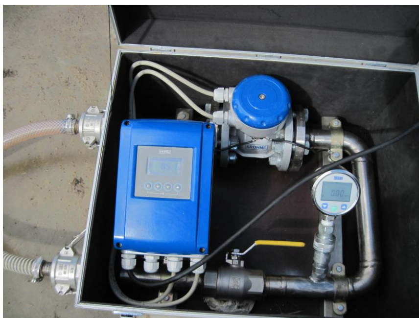
Slika 15. Uređaj za kontrolu protoka crpke Krohne
