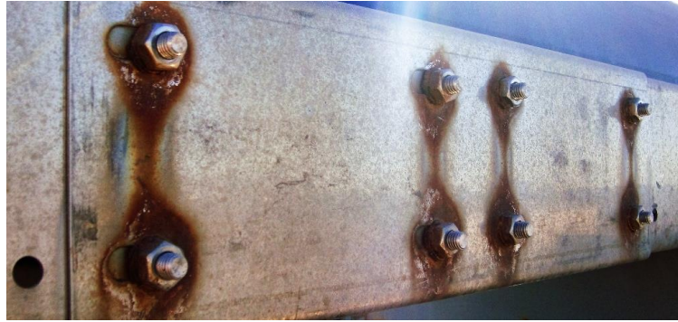
Slika 13. Galvanska korozija čeličnog nosača
