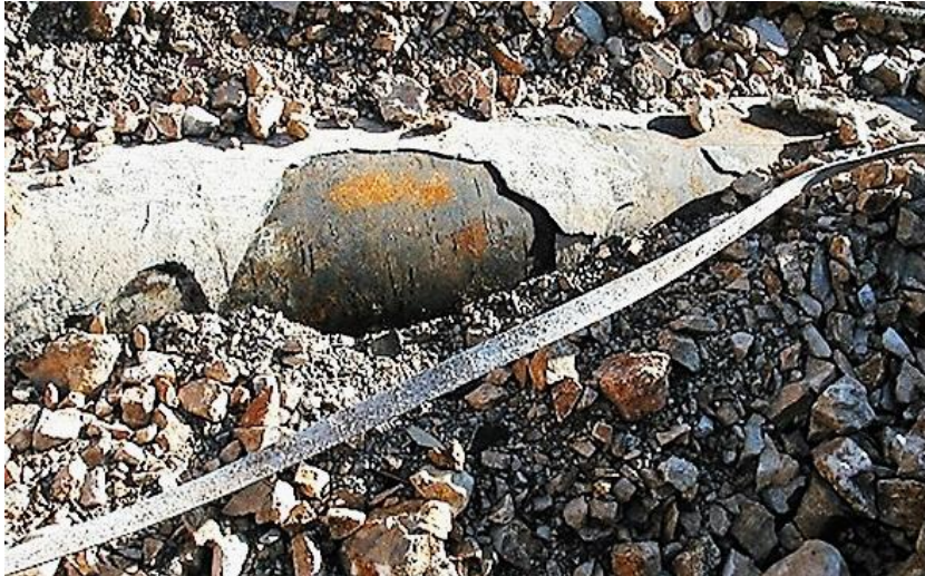
Slika 22. Korozija podzemnog spremnika
