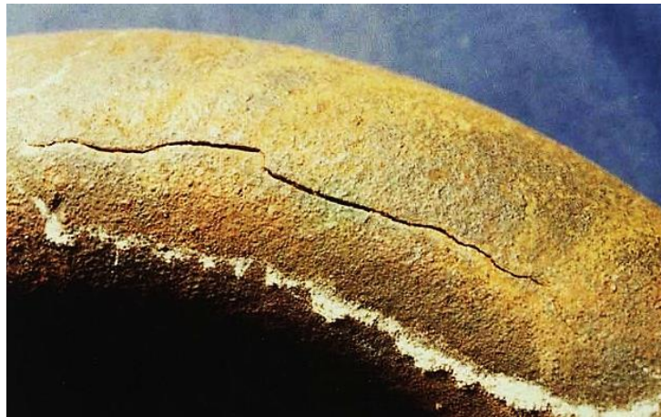
Slika 16. Primjer oštećenja uslijed napetosne korozije (Izvor: Horvat i sur., 2011.)
