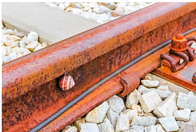
Slika 5. Elektrokemijska korozija tračnice i spojeva željezničke pruge
