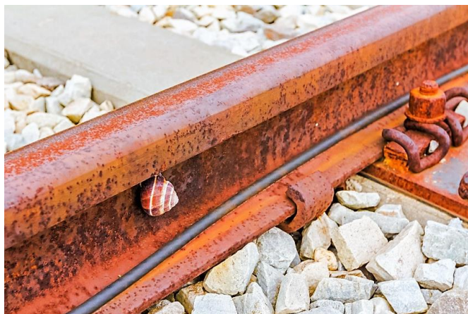
Slika 5. Elektrokemijska korozija tračnice i spojeva željezničke pruge
