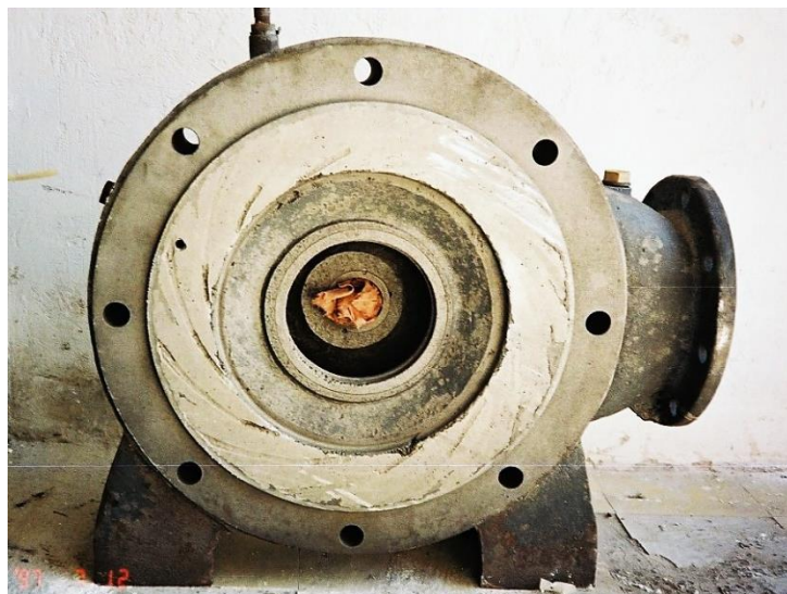
Slika 18. Erozijska korozija brtvene površine crpke (Izvor: http://belzona.hr/tag/erozija/ )
