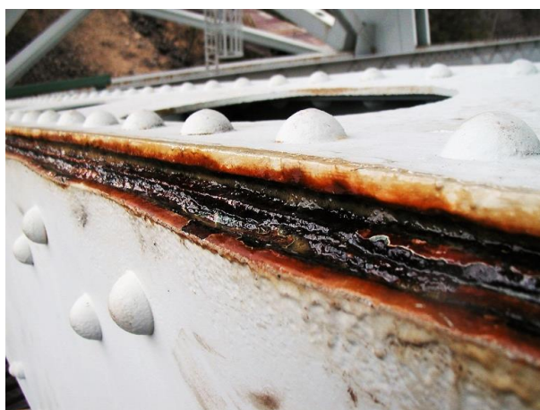
Slika 14. Procjepna korozija konstrukcije mosta
