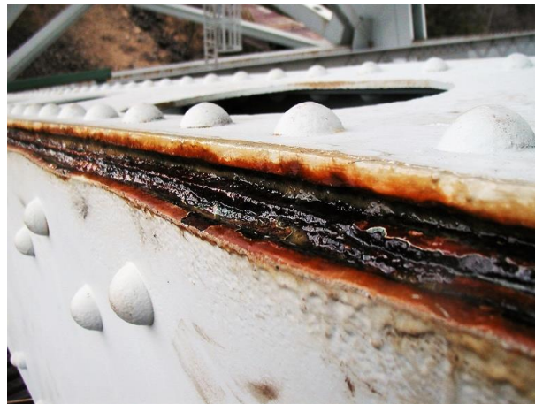
Slika 14. Procjepna korozija konstrukcije mosta
